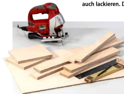
1 Schneiden Sie die Bauteile aus Multiplex bzw. Sperrholz mit der Stichsäge oder einer Handkreissäge zu.
